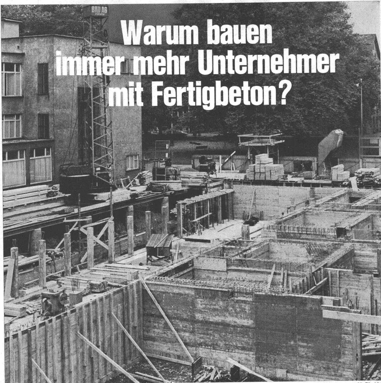
Erweiterungsbau Gewerbeschule der Stadt Zürich. Bauunternehmung: Bau AG für Hoch- und Tiefbau, Zürich 65. 72. 15d.
