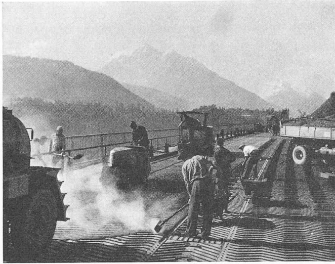
Bild 30. Fischgrätartig verlegte Stahlrippen auf ebenem Deckblech zur Sicherung des dünnen Schwarzbelages (Düsseldorfer Bauart)
