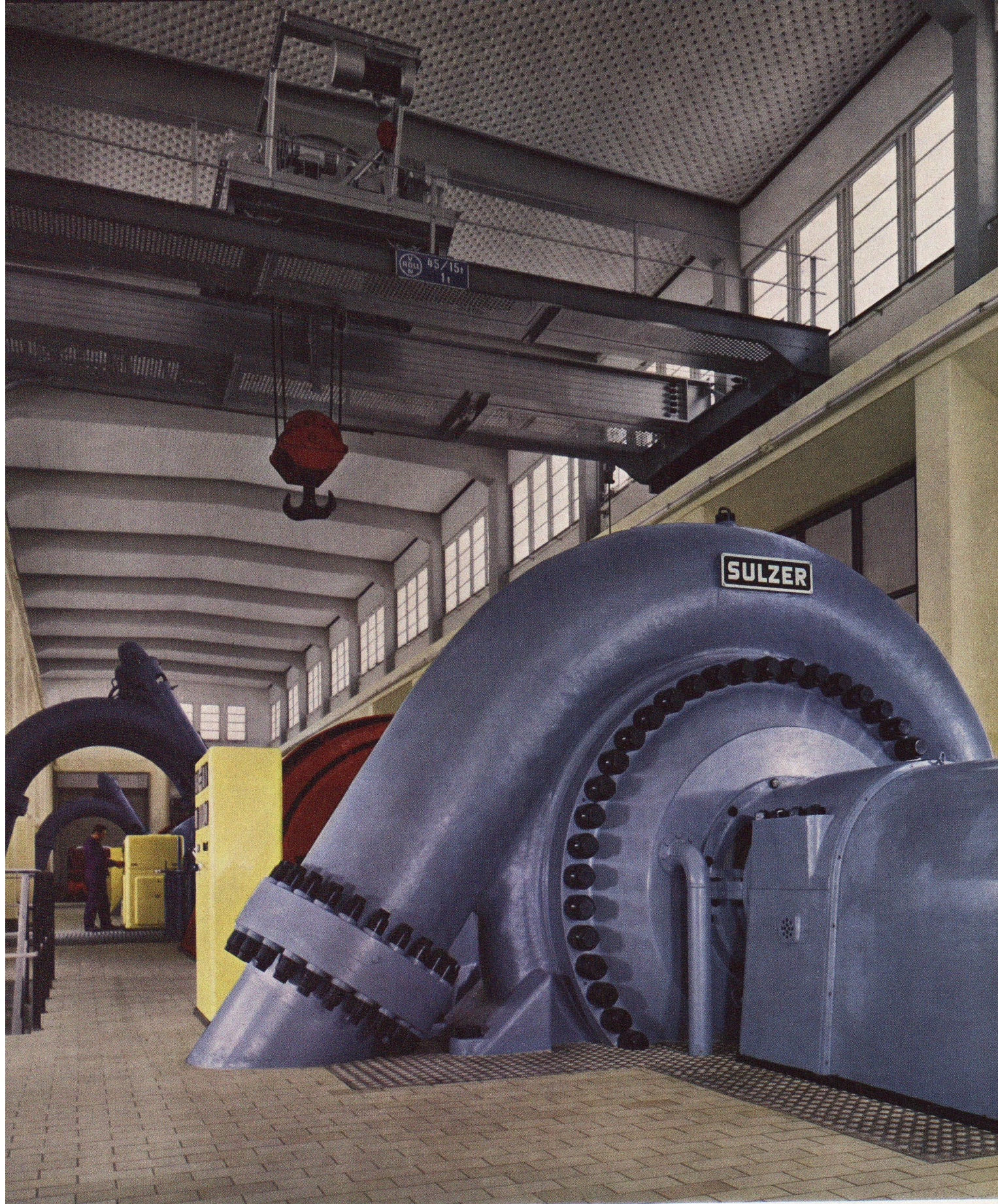
Centrale de Motec. Au premier plan la pompe d'accumulation
