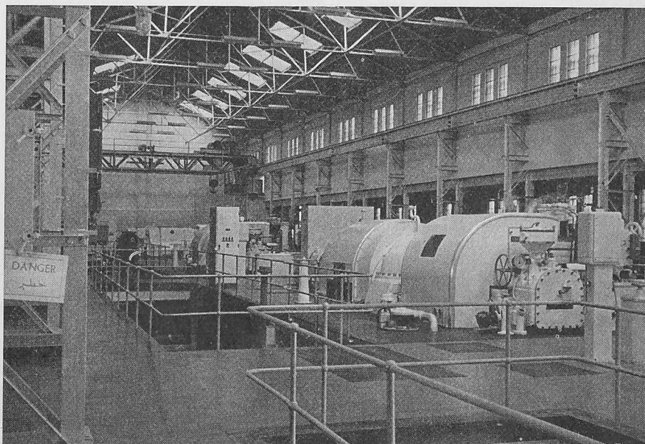
Bild 6. Kraftwerk Burri, neue 10-kV-Einheit
