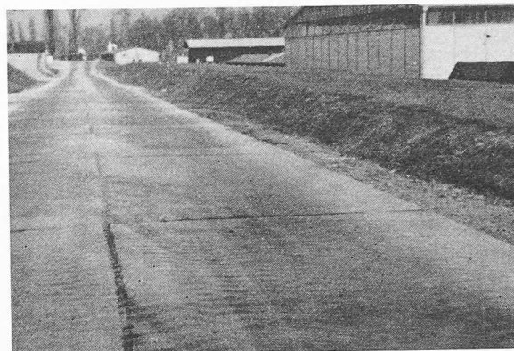
Bild 5. Prüfstrasse gemäss Bild 4 nach der Instandsetzung der Fahrfläche und nach über einjähriger starker Benutzung durch schwerste Kettenfahrzeuge. Die Riffelung auf der Betonoberfläche ist durch den Stollenabrieb bedingt
