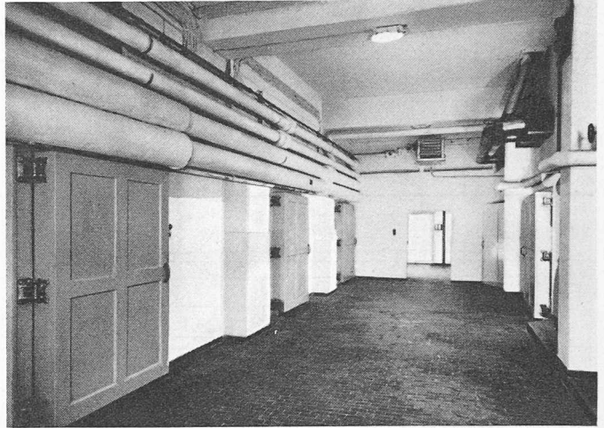
Bild 8. Vorraum 1, hinten Türe zu Vorraum 2, darüber unter der Decke Klimagerät, links Türen zu den Räumen 5 (vorn), 3 (Mitte) und 6 (hinten)
