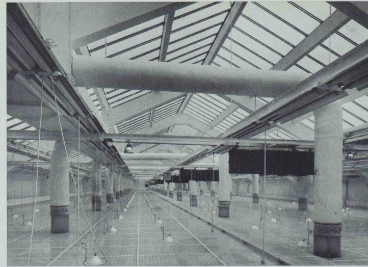
Dachraum mit Beleuchtungs- und Belüftungs-Installation; unten Ausstellungssaal
