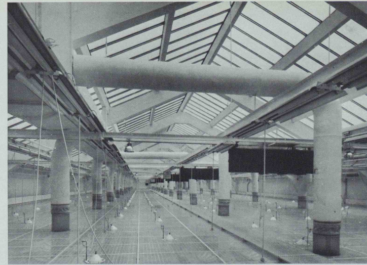
Dachraum mit Beleuchtungs- und Belüftungs-Installation; unten Ausstellungssaal
