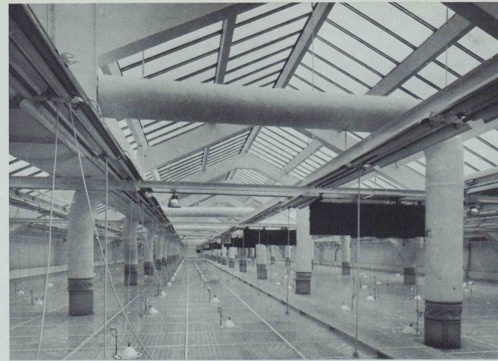
Dachraum mit Beleuchtungs- und Belüftungs-Installation; unten Ausstellungssaal
