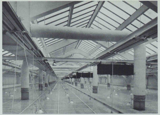
Dachraum mit Beleuchtungs- und Belüftungs-Installation; unten Ausstellungssaal
