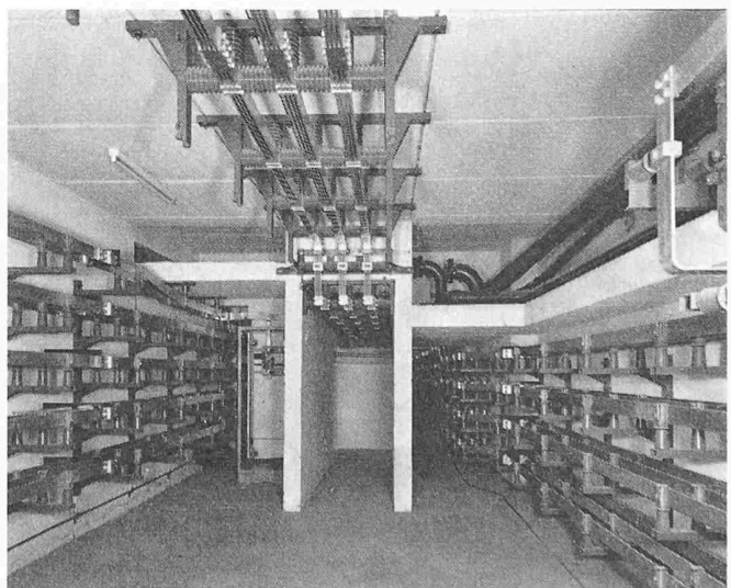
Bild 19. Abgang der Schienensysteme aus der Schaltanlage in die Schienenkanäle. Links und rechts die begehbaren Schienenkanäle; in der Mitte die getrennt geführte Hochleistungsleitung; oben rechts Kühlwasserleitungen
