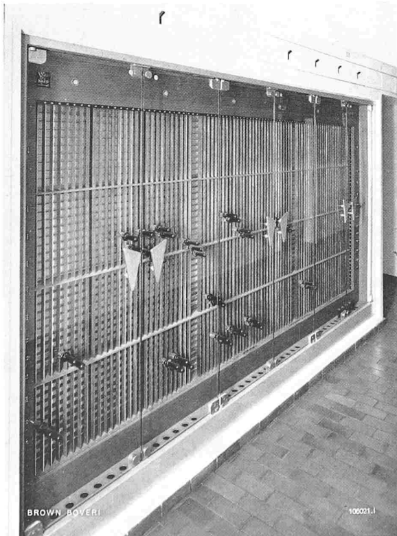
Bild 7. Der Hauptlinienwähler im Gang des Zweiten Obergeschosses. Darüber der mit Deckeln verschlossene Blechkanal zur Verteilung der elektrischen Energie 220/380 V
