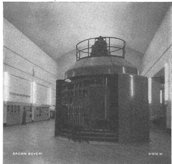
Bild 3. 23000-kVA-Synchronmotor, 1000 U/min, zum Antrieb einer zwei-stufigen Speicherpumpe, aufgestellt in einer Kavernenzentrale.
