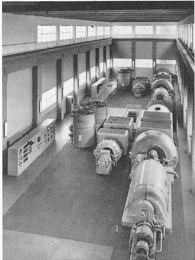
Bild 3. Maschinensaal mit zwei 25-MW-Gruppen. Von rechts nach links: Niederdruckteil, Hochdruckteil, Brennkammer, Instrumententafel
