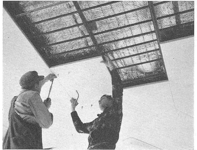
Bild 2. Hohlräumheizung mit Gipsplattendecke (Isolog, Zürich)
