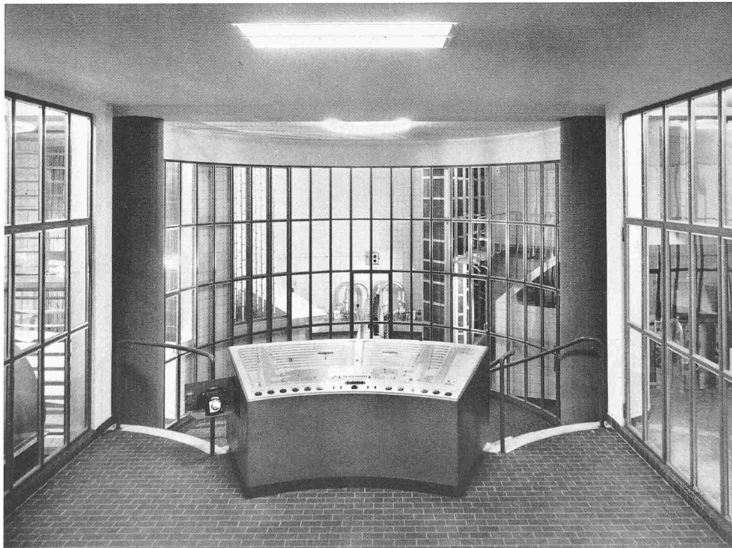
Zentrale Klimaanlage, Kommandopult
