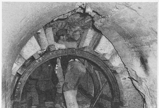
Fig. 14. Revêtement de granit en cours d'exécution (on distingue les briques éclatées du premier revêtement de béton)
