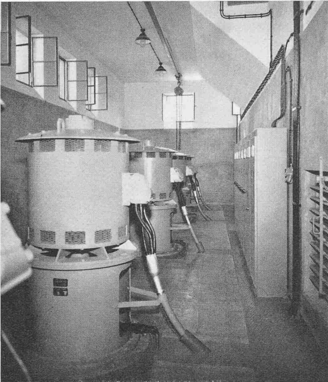
Bild 65. Motorenraum des Pumpwerkes Ranshofen
