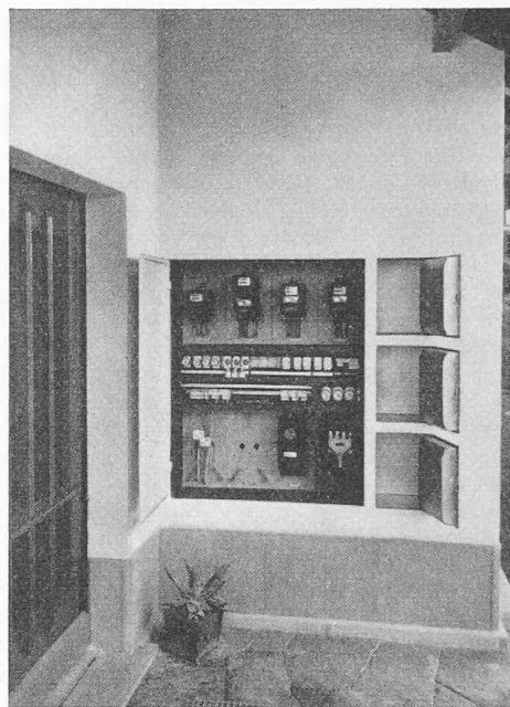
Bild 2. Der geöffnete Zählerkasten, die plombierbaren Isolierplatten vor Hauptsicherungen und Kabelendverschluss sind entfernt.
