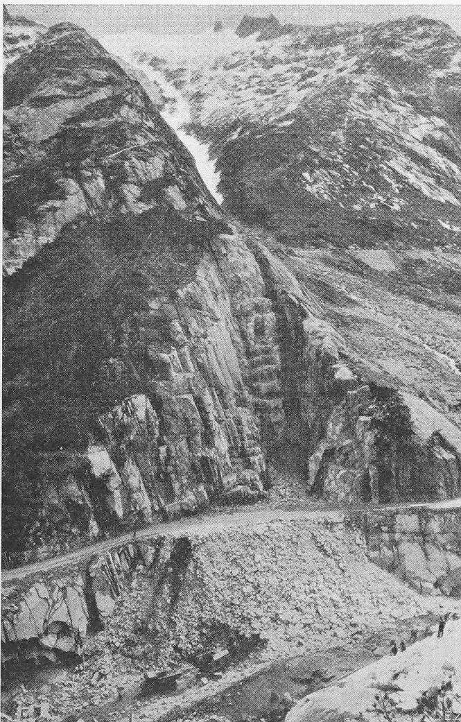
Bild 4. Felsausbruch des rechten Maueranschlusses; im Hintergrund der Gerstenbach
