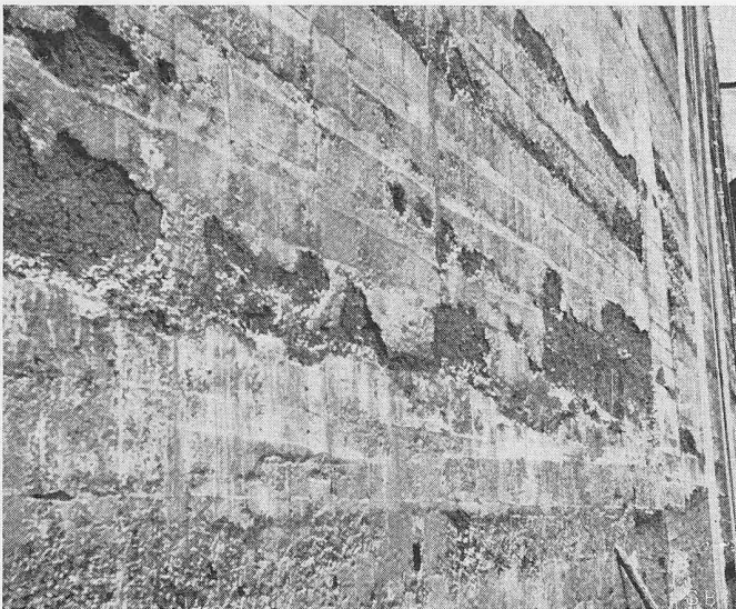
Bild 16. Einzelheiten zu Bild 15; der Beton ist durchgehend zerstört bis auf eine Tiefe von 15 bis 25 cm
