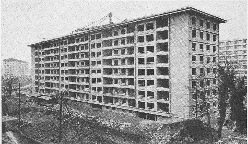
Bild 6. Neunstöckiger Wohnbau in Genf, skelettlose Ausführung mit tragenden Durisol-Mauersteinwänden, Architekt F. JENNY, Zürich
