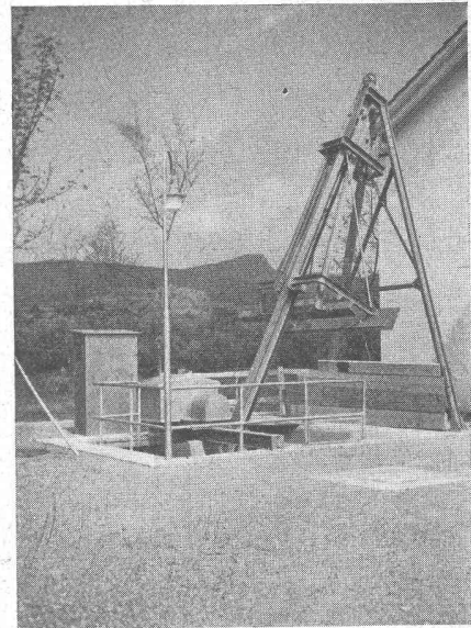
Abwasserpumpwerk am Gönhardkanal Automatische Rechenreinigungsmaschine
