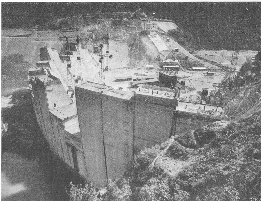
Bild 33. Kraftwerkgruppe Piave-Boite-Vajont: Uebersicht auf die Baustelle für die Bogengewichts-Staumauer Pieve di Cadore. Im Hintergrund die Betonaufbereitungsanlage und die Zementsilos; der Zement wird von der nahe gelegenen Bahnstation direkt in diese Silos gepumpt; Bauzustand Aug. 1949. Die Betonierungsarbeiten wurden bereits anfangs November 1949 beendigt
