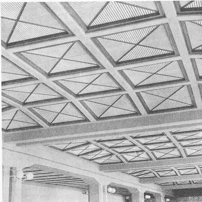
Bild 13. Schallschluckende Deckenfüllungen (Pavatex mit Naturholzrahmen)
