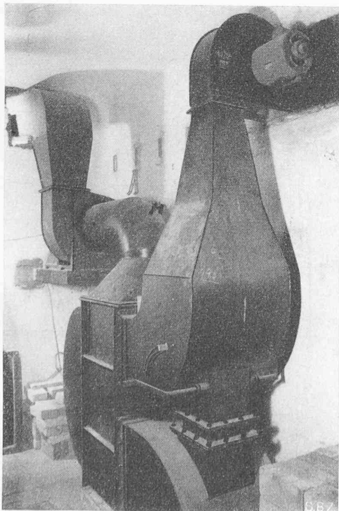
Bild 7. Wärmeaustauscher, noch nicht isoliert. Rechts oben: Unterwindgebläse, Links hinten: Saugzuggebläse
