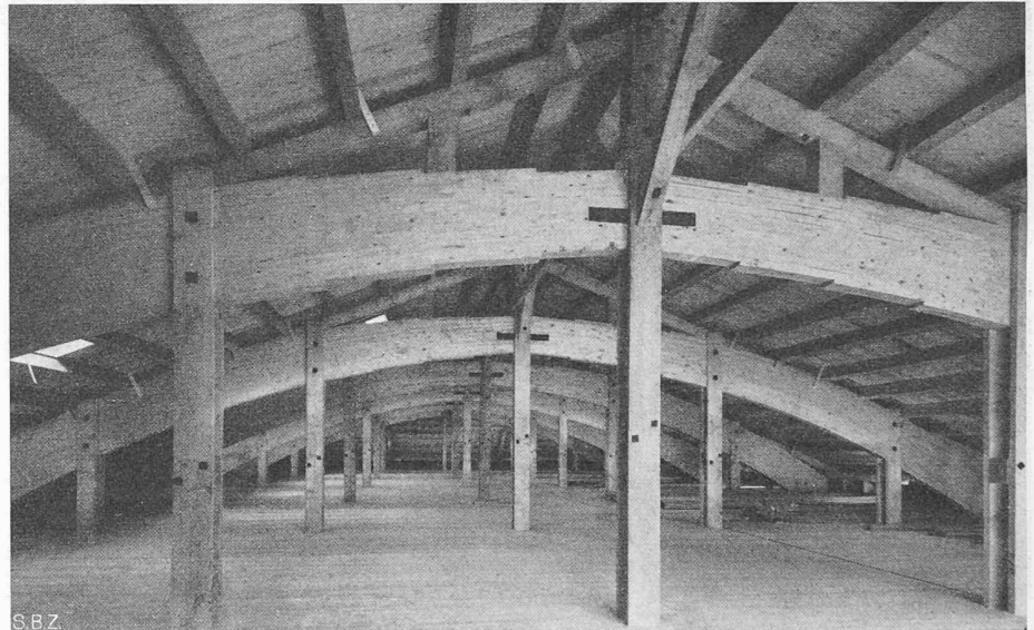
Bild 16. Dachboden des Neubaus an der Laufengasse der S. I. G., Neuhausen am Rheinflall
