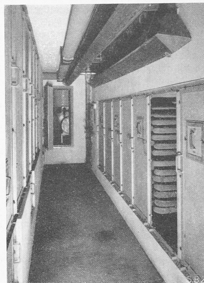
Bild 10. Bedienungsgang mit Luftkühler im Obergeschoss, rechts ein Feld der Verschaltung offen
