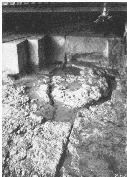
Bild 27. Fuge zwischen Widerlagercaisson (rechts) und Schwellenplatte (links), dahinter Beton des Fugenschlusses zwischen oberem Schwellencaisson und Widerlagercaisson und neu verlegte Granitquader unter Dammbalken
