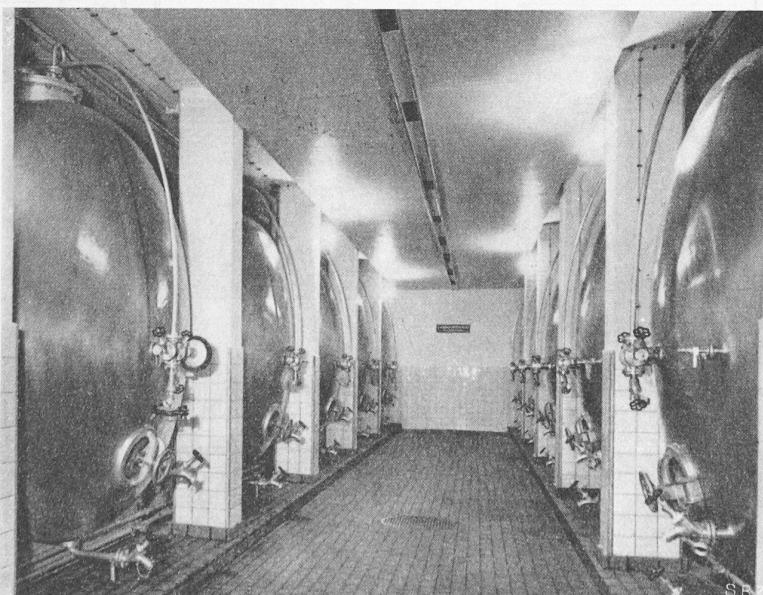
Bild 18 (links). Lagerkeller mit Obstsafttanks des Aluminiumschweisswerkes Schlieren. An der Decke Rückluftkanal aus Pavatex mit Absaugeöffnungen
