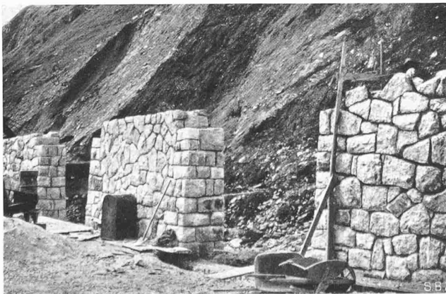
Abb. 4. Pfeiler für Lawinengalerie: grosse Vertikallasten erfordern lagerhaftes Mauerwerk, nicht solche regellose Steinhaufen
