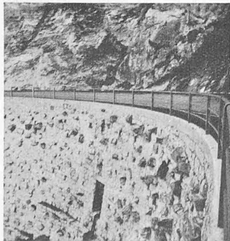
Abb. 3. Gegenbeispiel: Schichtenmauerwerk mit vorstehenden Spitzbossen
