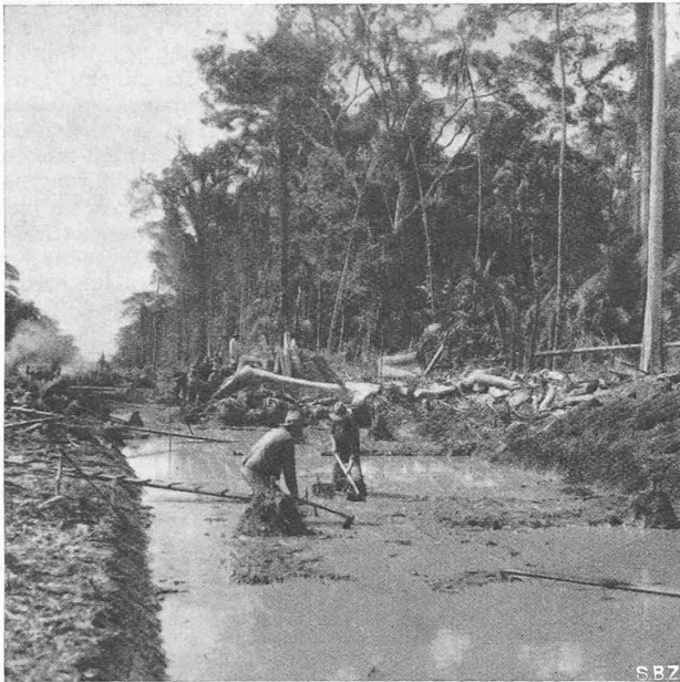
Abb. 6. Seitlicher Aushub für Dammschüttung in schlammigem Boden, Gesamtlänge hiervon 10 km, Kubatur 130 000 m 3
