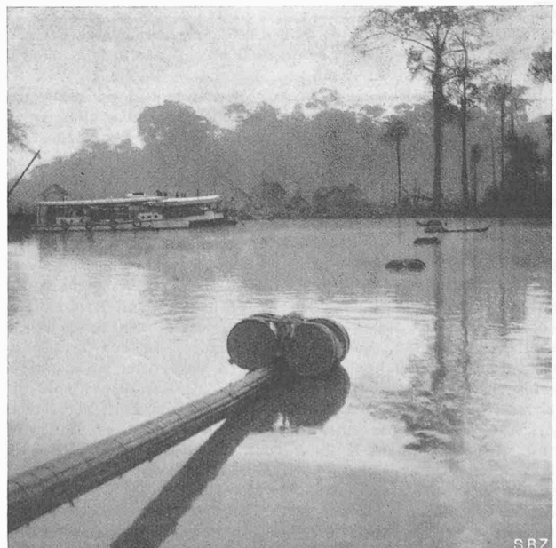
Abb. 11. Legen der isolierten Oelleitung durch den Lalangfluss, auf dessen Sohle sie von den Schwimmern abgesenkt wird
