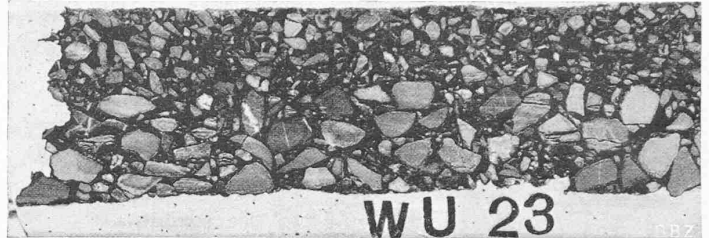
Abb. 6. Schnittfläche durch zweischichtigen 5 cm starken, nach dem Salviäm-Verfahren heiss eingebauten Asphaltteerbetonbelag Kugelilostr. Zürich-Affoltern, 1938
