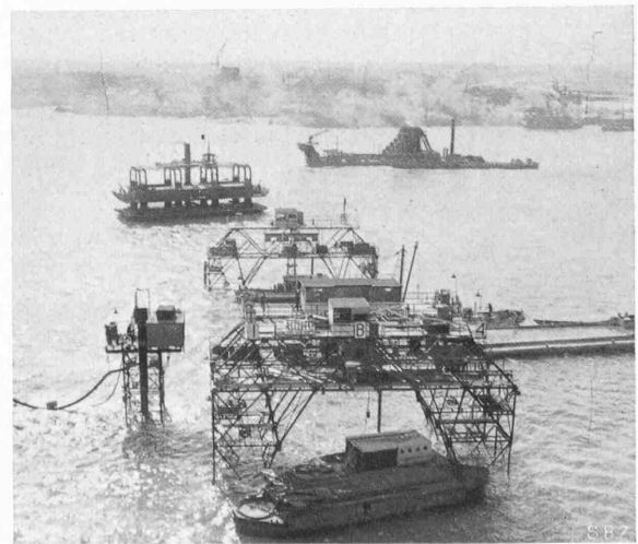
Abb. 21. Links neben den Richttürmen der Spülturm Bauausführung der Fluss-Strecke beim Autotunnel unter der Maas in Rotterdam
