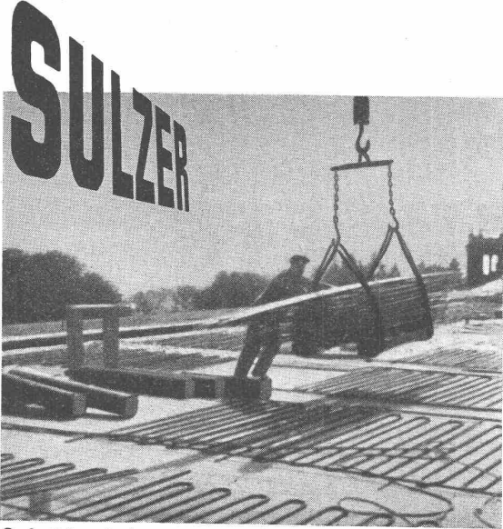
Gebrüder Sulzer Aktiengesellschaft Abt. Zentralheizungen Winterthur und Filialen
