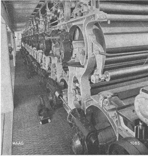
Antrieb von Trockenzylindern in schweizerischer Papierfabrik mittels Maag-Schneckengetrieben. Insgesamt 26 Getriebe geliefert für diese Anlage.
