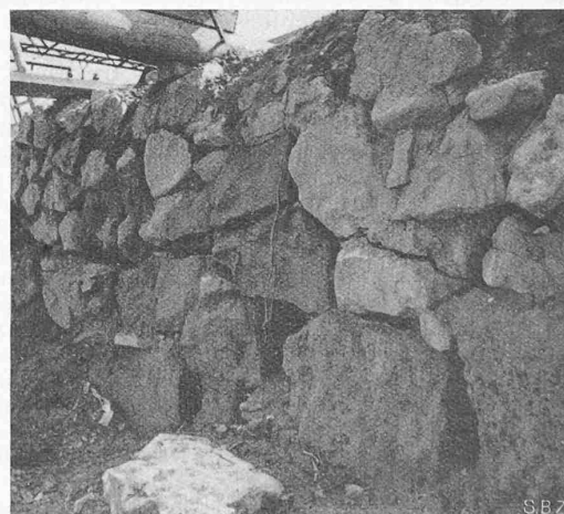
Abb. 56. Zustand der alten Mauer, Rückseite
