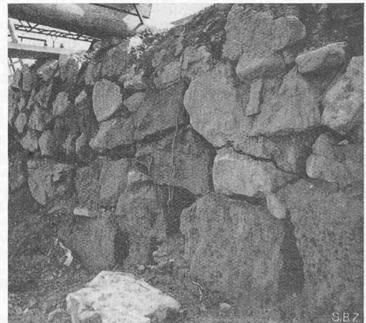
Abb. 56. Zustand der alten Mauer, Rückseite
