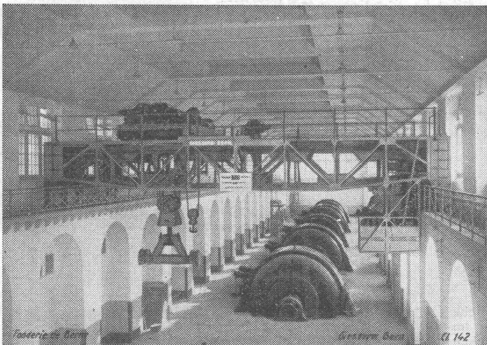
100 Tonnen Laufkran mit Lasttraverse in der Zentrale Amsteg der S. B. B.
