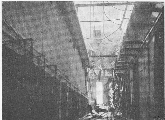
Abb. 4. Blick vom nördlichen Ende des Mittelganges im Transformator-Geschoss (über dem Generatorensaal) gegen Süden.
