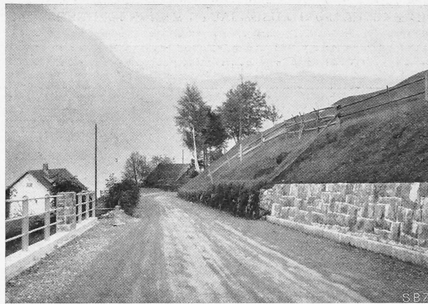
Abb. 10. Ende der Ausbaustrecke im Herbst 1933 bei Stocken, im Hintergrund die alte Strasse 4 1/2 m breit, vorn erweitert auf 6,5 m.
