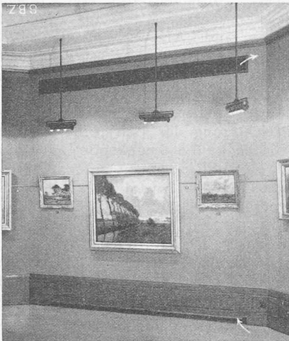
Abb. 8. Sirco-Einbau in einer Gemäldesammlung.
