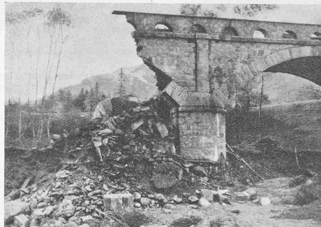
Abb. 7 und 8. Zerstörung der alten Castelmur-Brücke am 25. Sept. 1927.
