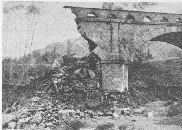
Abb. 7 und 8. Zerstörung der alten Castelmur-Brücke am 25. Sept. 1927.
