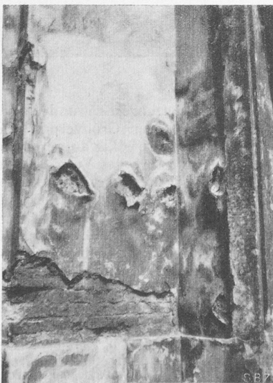
Abb. 9. Aufgeplatzte Blasen (Verwitterungskrater) in harter und wenig durchlässiger Zementverputzschicht.
