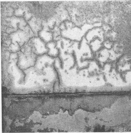
Abb. 6. Risse im Verputz als Bahnen der zur Oberfläche vordringenden Mauerfeuchtigkeit. In Umgebung der Risse erfolgt Verfärbung.
