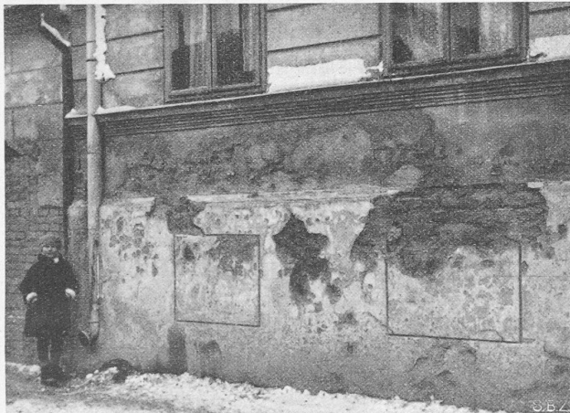
Abb. 8. Abfallen grosser Platten eines dichten, dichten Verputzes von der Hausmauer (links wo das Kind steht), sowie im obern Teil des Sockels am Gebäude rechts. Zwischen Sockeloberkante und Fenstergesims ist die Verputzschicht von geringerer Dicke, es erfolgt hier Feuchtigkeitsaustritt zur Oberfläche bei teilweisem Blasenwurf. Die Infiltration reicht über das Fenstergesims. Auch hier erfolgt wieder (im Bilde nicht sichtbar, da weiter rechts) Aufplatzen des in dicker Schicht aufgetragenen Putzes und Abwerfen ganzer Schollen.
