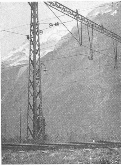
Abb. 12. Durch Gewicht nachgespannte Leitung.
