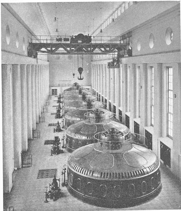
Abb. 47. Blick vom Kommandoraum in den Maschinensaal.
