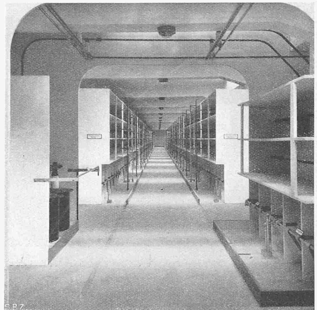
Abb. 31. Sammelschienen-Systeme IV und III im Obergeschoss.
