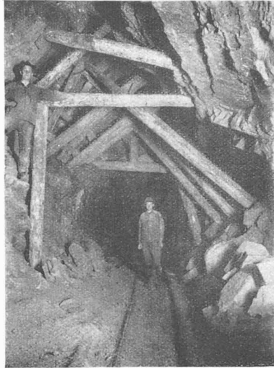
Abb. 34. Niederbrüche bei Fenster 6 (20. VII. 21).
