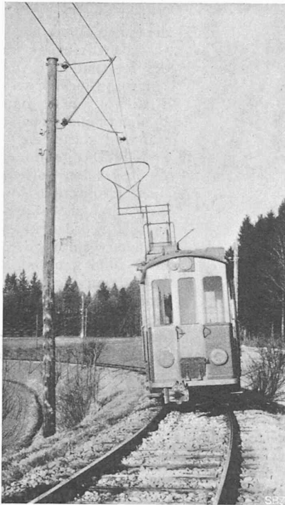
Abb. 2. Fahrleitung der Uetlibergbahn.
