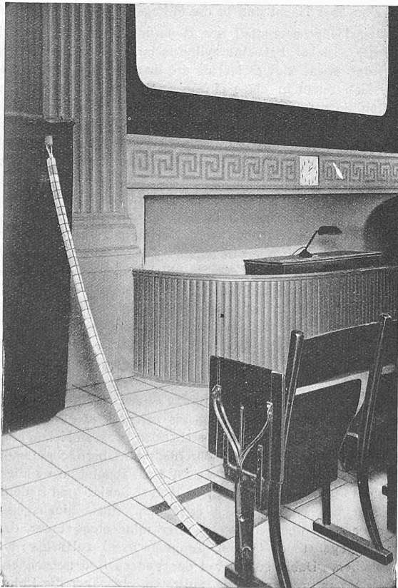
Abb. 5. Elektrische Fussbodenheizung in einem Lichtspieltheater. (Der biegsame Heizkörper ist aus seinem Kanal herausgezogen.)
