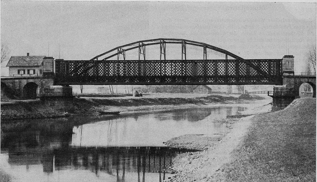
Abb. 3. Brücke der S. B. B.-Linie Zürich-Chur über den Linth-Kanal bei Weesen. — Stützweite 49,6 m. Im Jahre 1859 von Ing. G. Dollfus in Mülhausen erbaut. (1897 von der A.-G. Th. Bell & Cie. in Kriens durch einen Bogen verstärkt.)
