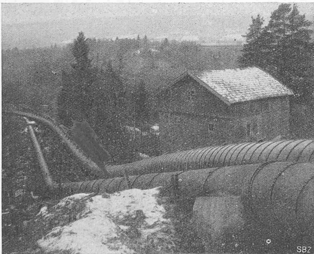
Abb. 6. Hölzerne Druckleitung (rechts) des Kraftwerkes Eidsvold, Durchmesser 1000 mm, Drukhöhe 48 m; zum Ersatz der links davon liegenden ältern Eisenrohrleitung.
